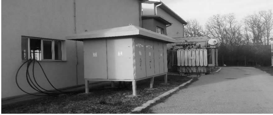
SLIKA 3 – MOBILNA TS 35/10 kV/kV POSTAVLJENA I SPREMNA ZA DALJE POVEZIVANJE
